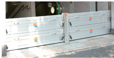
駅出入口の止水板
