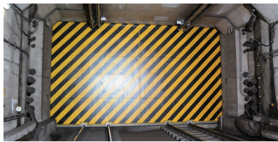
トンネルの断面を閉鎖する防水ゲート
