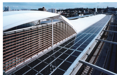
駅に設置された太陽光発電パネル
