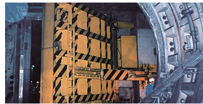
トンネル内の防水ゲート
