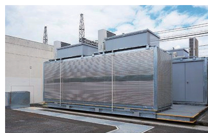
回生電力貯蔵装置
