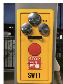
非常停止押しボタン
