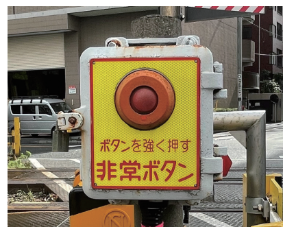
支障報知装置(非常ボタン)
