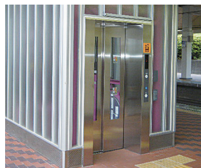
エレベーター
