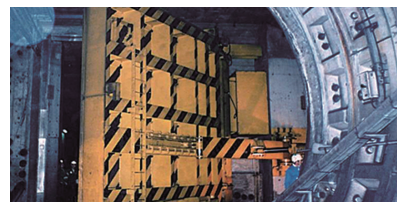
トンネル内の防水ゲート
