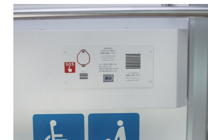
非常通報装置
