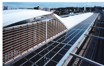
駅に設置された太陽光発電パネル
