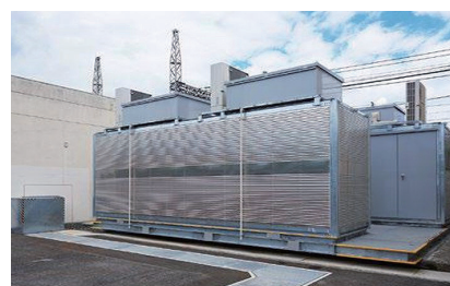
回生電力貯蔵装置
