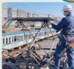
でんけん パンタグラフの点検
